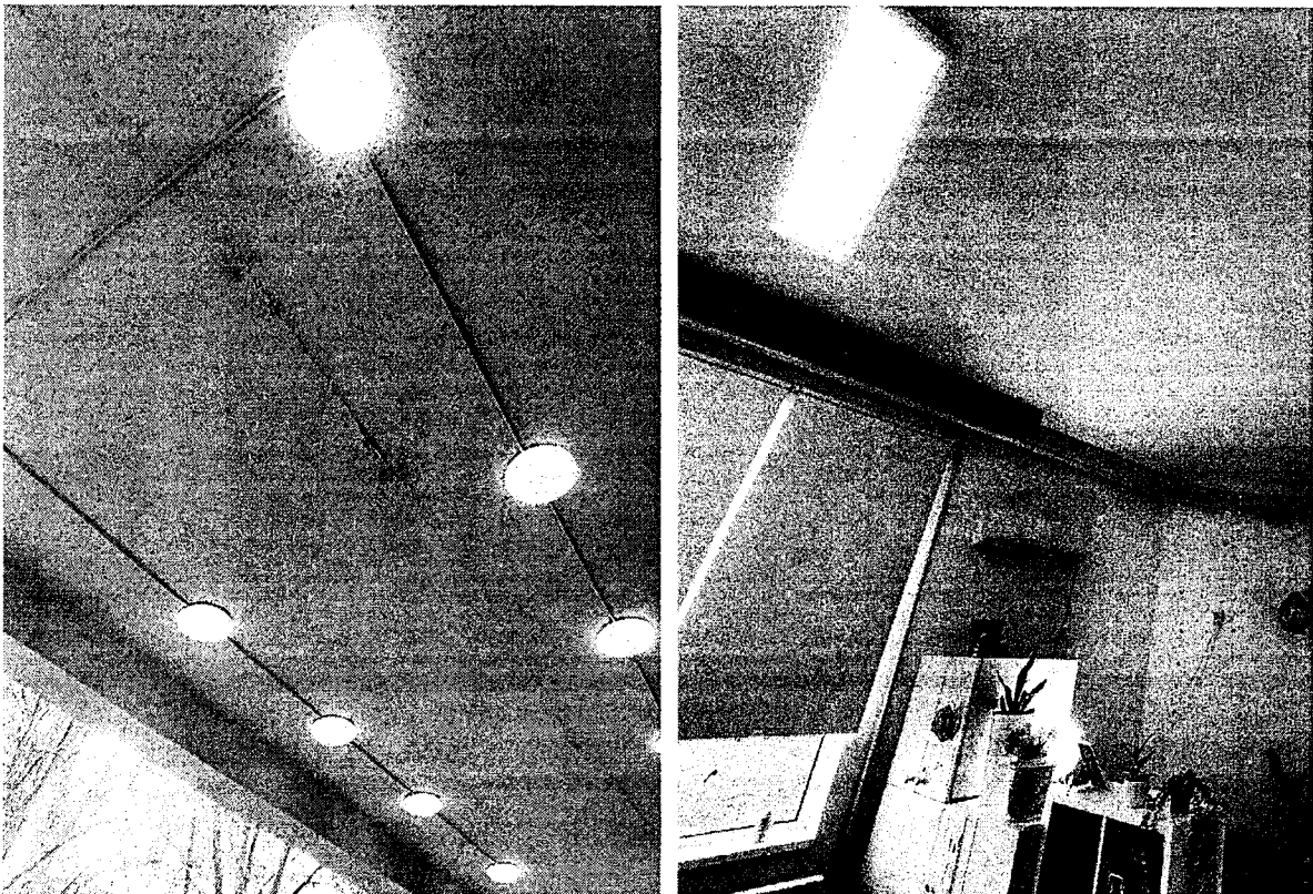
Слика 0.6 – LED расвета уграђена у објекту
