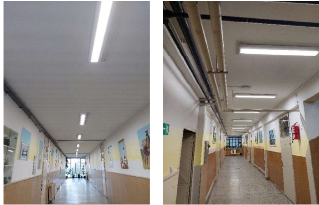
Слика 0.6 – LED расвета унутар објекта
